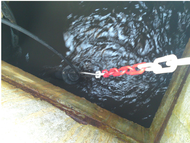
Obr. 3 Inštalácia na Odtoku
